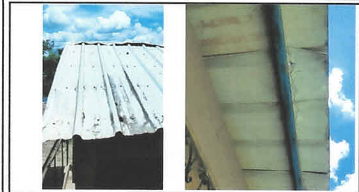
Foto1: La cubierta de lámina se ha dañado por el paso del tiempo, especialmente el módulo que se mantuvo debajo de un árbol que oxido la lámina y ocasionó agujeros con el ácido de sus hojas.
