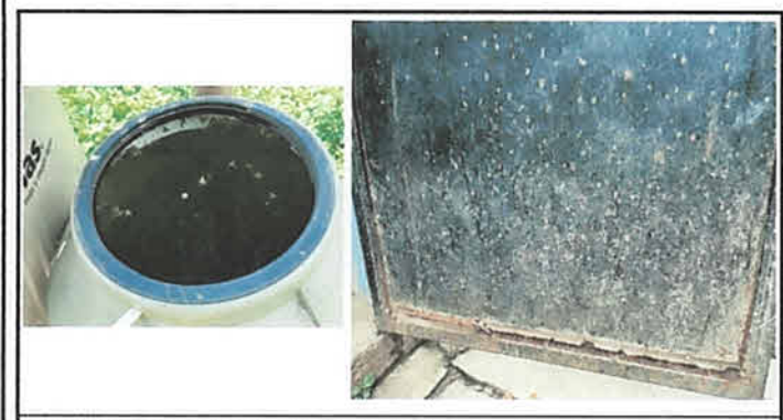
Foto 5: Los tinacos no cuentan con tapaderas para mantener limpia el agua ni con sistema de llenado automático (llave de flote) las puertas se han picado con el paso del tiempo y requieren sustitución
