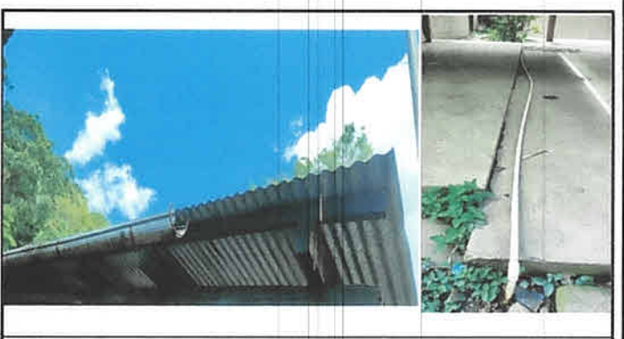
Foto 6: El canal recolector de agua se ha picado y desprendido de su lugar mas la tubería se mantiene rompiendo constantemente porque se encuentra sobre la banqueta de paso peatonal.
