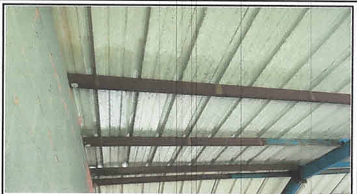
Foto 2: La estructura que sirve para cargar las láminas fue instalada sin protección de pintura anticorrosiva, lo que ha ocasionado corrosión por el oxido en todos los elementos, requiriendo un mantenimiento y pintado
