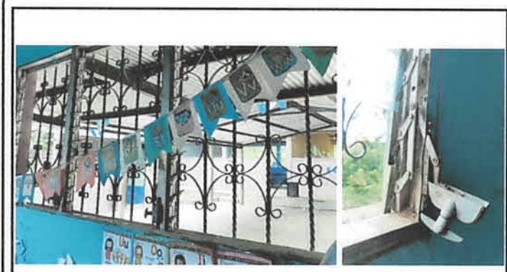
Foto 3: Las aulas tuvieron ventanas que con el paso del tiempo se fueron deteriorando y desarmando por lo que se requiere cambio de ventanas
